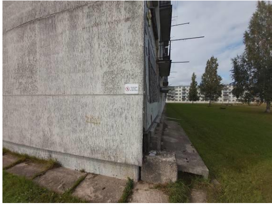
Mājas daļa, kas cieta gāzes sprādzienā
