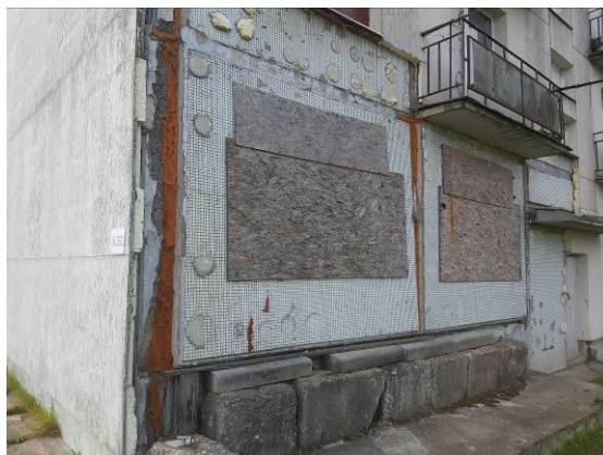
Mājas daļa, kas cieta gāzes sprādzienā
