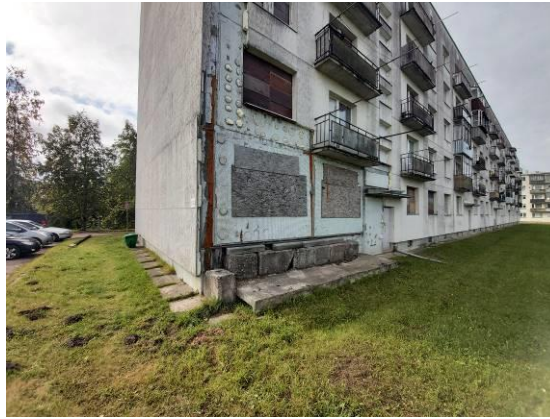
Mājas daļa, kas cieta gāzes sprādzienā
