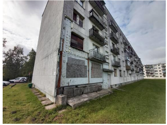
Mājas daļa, kas cieta gāzes sprādzienā
